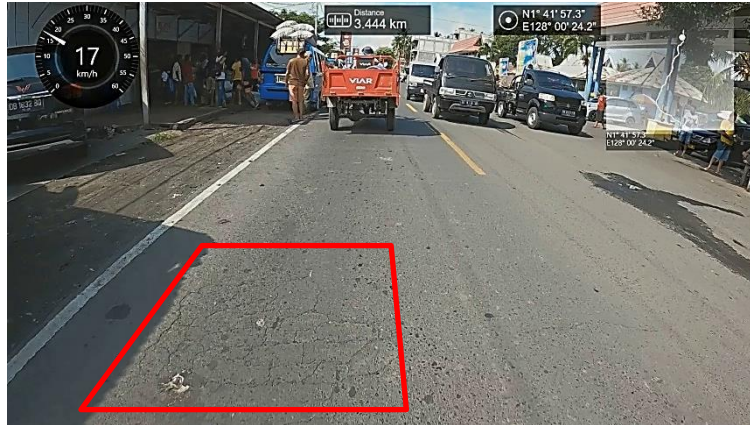
Gambar 7. Kerusakan retak buaya pada Sta. 34 + 400 – Sta. 34+500
